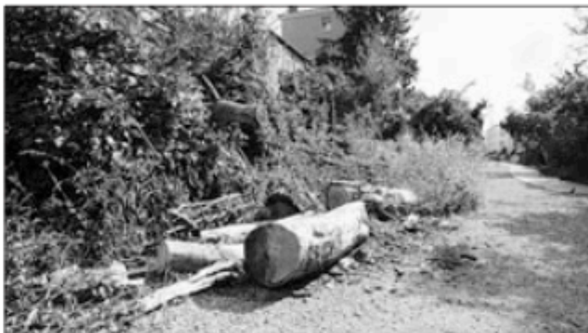
I lavori sulla ciclabile che congiunge San Giacomo e Draga S. Elia
